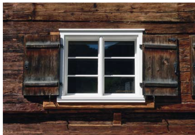
▲ Von den historischen Fenstern waren nur wenige Flügel brauchbar. Als Ersatz rekonstruierte ein Schreiner die Kastenfenster: außen mit Einfachverglasung, innen mit Isolierglas
